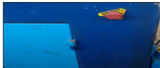
Figura 13: Máquina com botão, porém a identificação está danificada.
